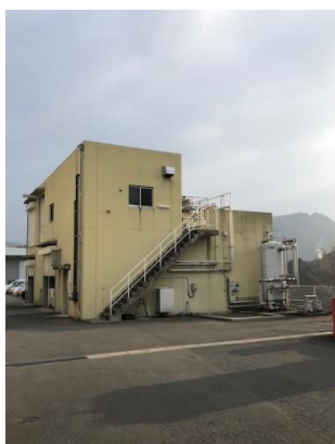
排水処理設備
